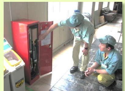
屋内の消火設備講習
